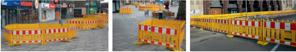
Bilder 3, 4 und 5: Einhausung von Gefahrenstellen
