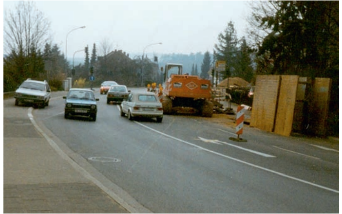
Bild 1: Nicht genehmigte Ausweitung der Baustelle mit Verkehrsgefährdung
